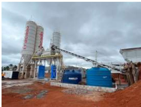
Figura 4 - Central de concreto dosadora e misturadora Betonmac Neo 120.
