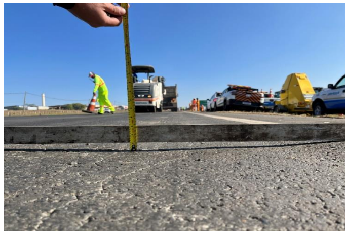
Figura 8 – Afundamento de trilha de roda
