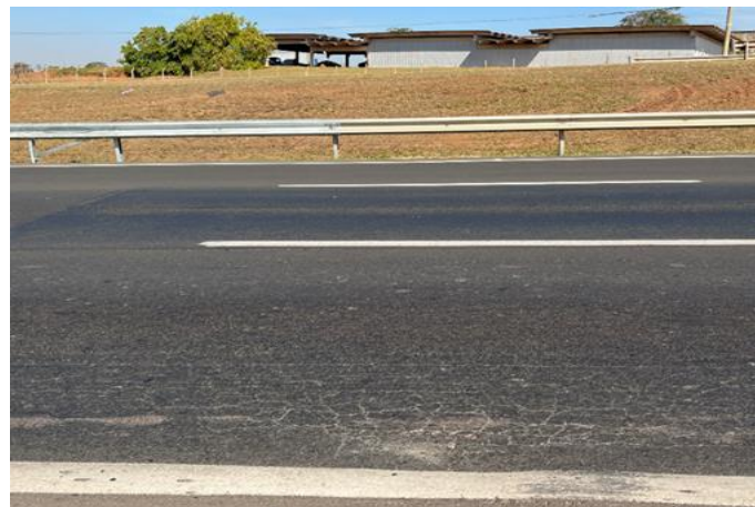
Figura 5 – Trincamentos do tipo FC-3
