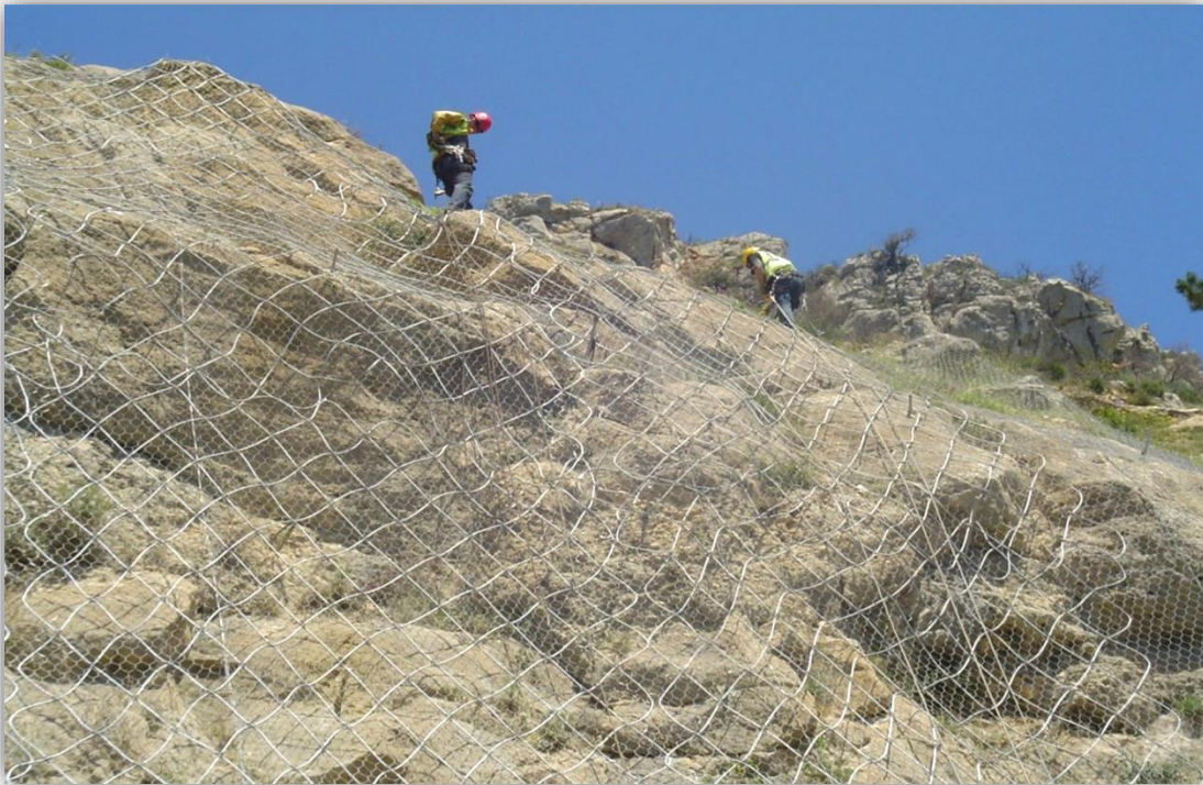
Rede metálica de proteção
