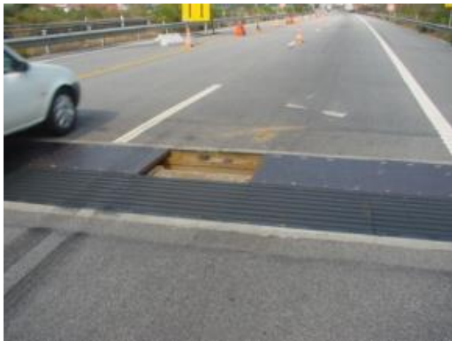
Junta de dilatação solta e respectivas consequências na segurança dos veículos
