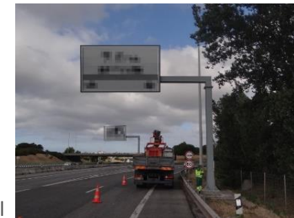
Estruturas de sinalização vertical
