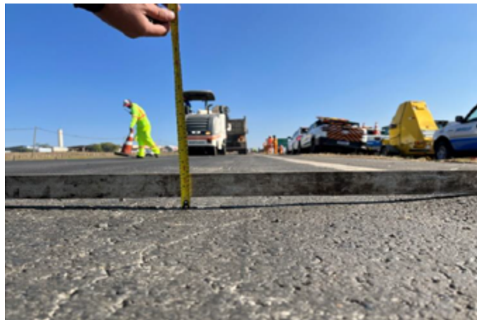
Figura 8 – Afundamento de trilha de roda
