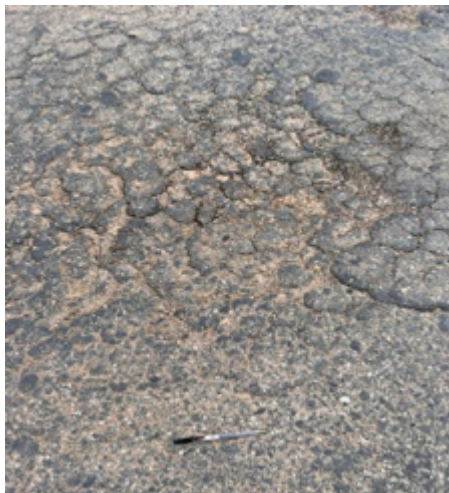
c) trinca couro de jacaré com erosão
