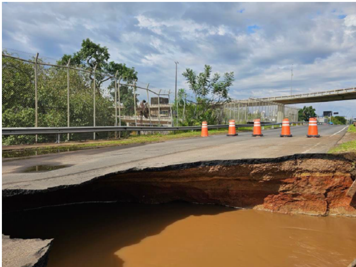
Figura 13. Danos severos no pavimento da rodovia BR-290
