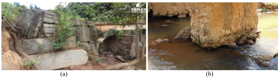
Figura 5. (a) Caso típico de falta de projeto para os encontros/alas das pontes; (b) Erosão dos materiais pela correnteza do rio, devido à falta de enrocamento para proteção dos encontros e dos pilares. (DER-ES, 2024)
