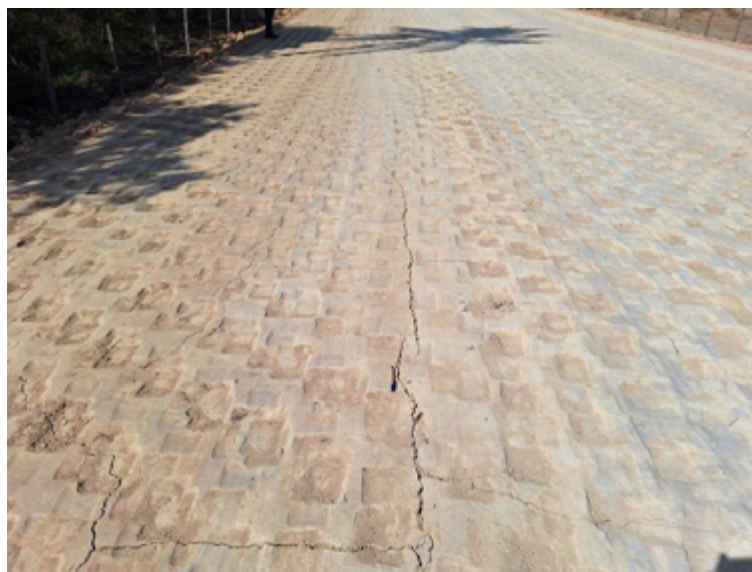
Figura 9. Trincas apresentadas na camada de um solo LG' entre as estacas 78 e 108. (AUTOR, 2024).
