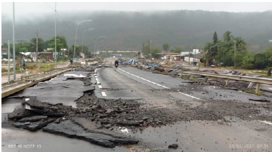
Figura 12. Danos severos no pavimento da rodovia BR-386
