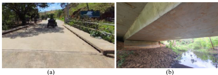
Figura 8. (a) Tabuleiro com pouco desgaste natural; (b) Super e mesoestrutura em bom estado, necessitam de serviços simples de manutenção e limpeza, sem indícios de danos que possam gerar insuficiência estrutural. (DER, 2024)
