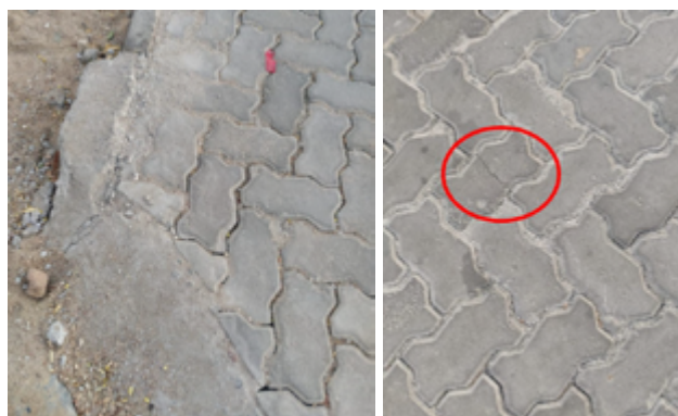
Figura 7. Falhas observadas na inspeção final (AUTORES, 2024)
