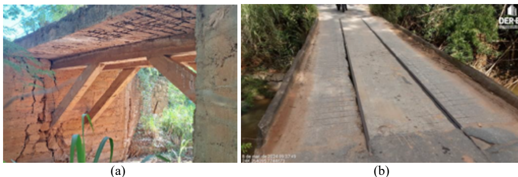
Figura 4. (a) Tabuleiro com oxidação das armaduras e deslocamento do concreto (falta de cobertura), ruptura estrutural do encontro; (b) Desgaste e deformação excessiva do tabuleiro devido ao tráfego intenso e falta de manutenção periódica. (DER-ES, 2024)
