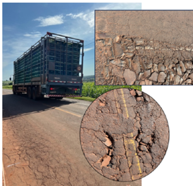
Figura 08: Condições do pavimento avaliado (AUTORES, 2024).
