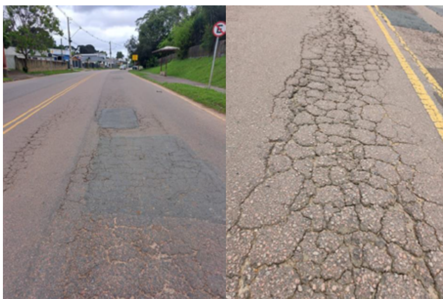
Figura 1. a) Visão geral do pavimento da rua Nicolla Pellanda; b) Realce para as trincas interligadas tipo couro-de-jacaré encontrados na Rua Nicola Pellanda
