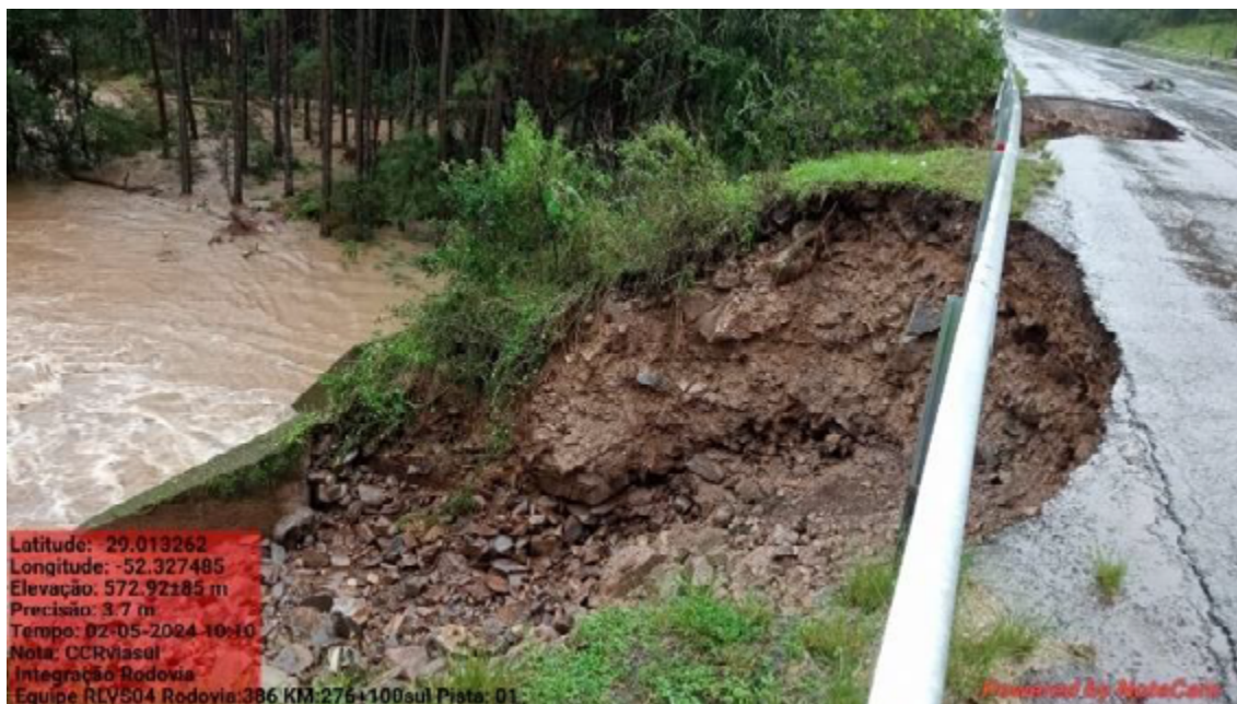
Figura 11. Ruptura de talude no km 276 da rodovia BR-386
