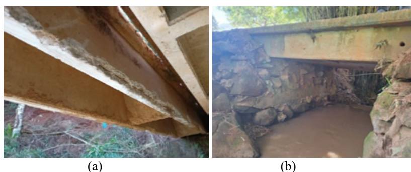
Figura 6. (a) Deslocamento e oxidação das armaduras; (b) Construção dos encontros sem projeto, remoção dos materiais pela correnteza, devido à falta de enrocamento de proteção. (DER-ES, 2024)
